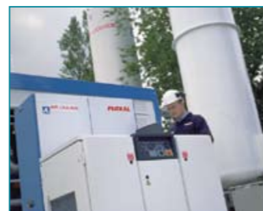
Generador de gas "in situ"
